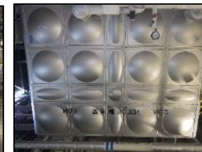
飲料水タンク
