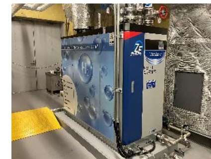
水素ボイラー
