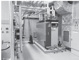
①水素専焼ボイラ
