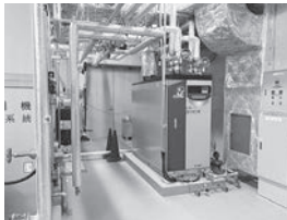
①水素専焼ボイラ
