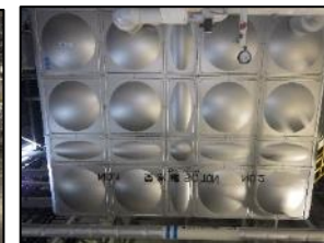
飲料水タンク
