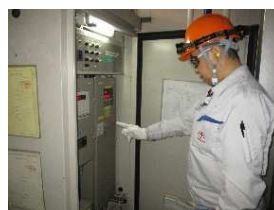
排ガス分析計確認の様子
